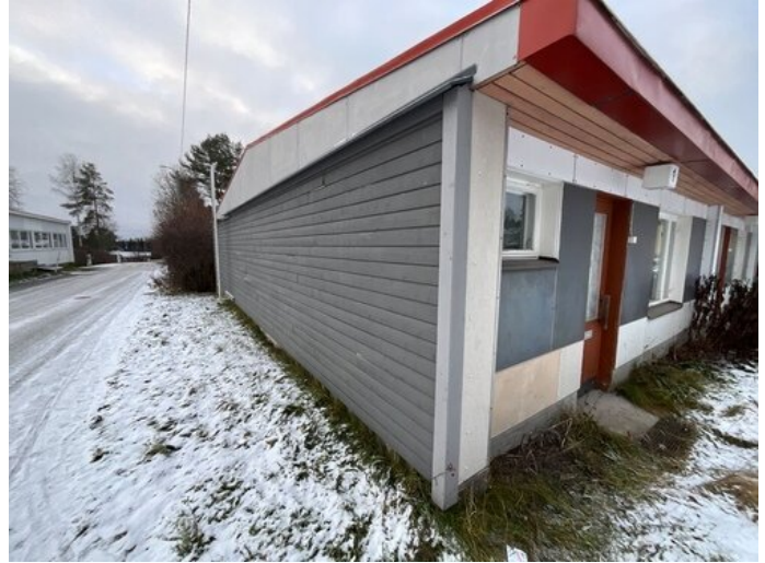
Kuva 2 Julkisivujen asbestipitoinen kuitusementtilevy on myös päätyihin asennetun puuverhouksen alla.
