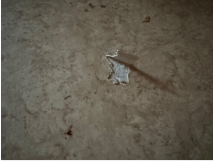
Kuva 9 Lattiamatossa selvä asbestipahvikerros
