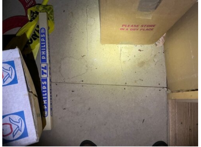
Kuva 6 Kylmän, rakentamattoman ullakon lattiassa paikoin lastulevy
