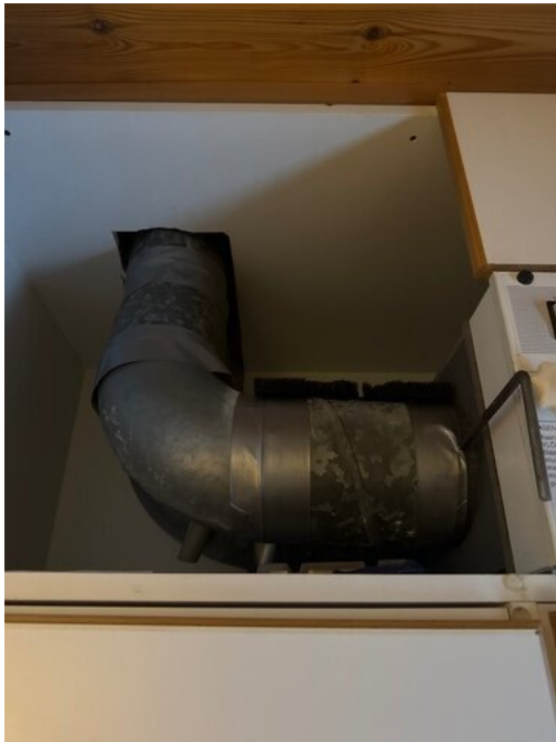
Kuva 15 Ilmanvaihtokanavat teräksistä kierresaumaputkea.
