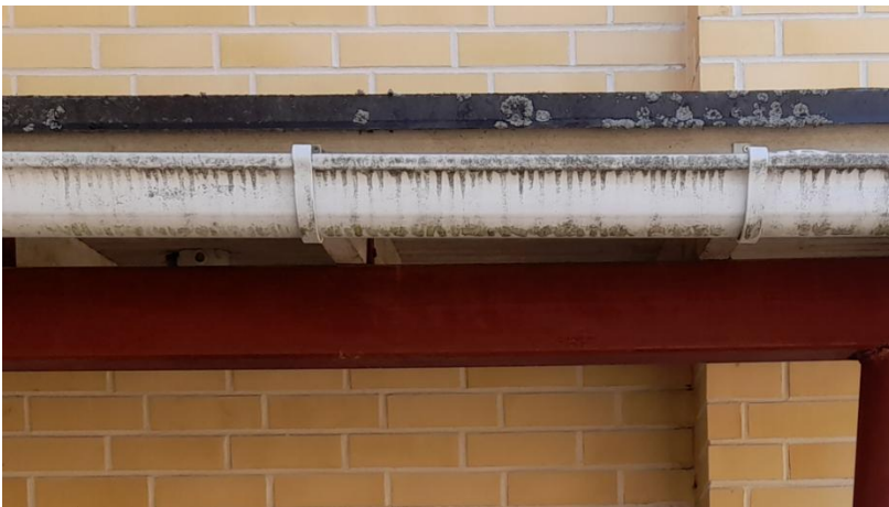
Kuva: pestävät räystäskourut
