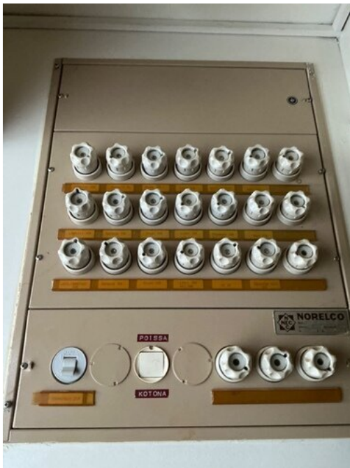
Kuva 7 Sähkökeskusten ja sulaketaulujen taustana on usein asbestipitoinen kuitusementtilevy. Levy tulee toimittaa jäteasemalla paikallisen jätehuoltoyhtiön ohjeiden mukaisesti pakattuna.
