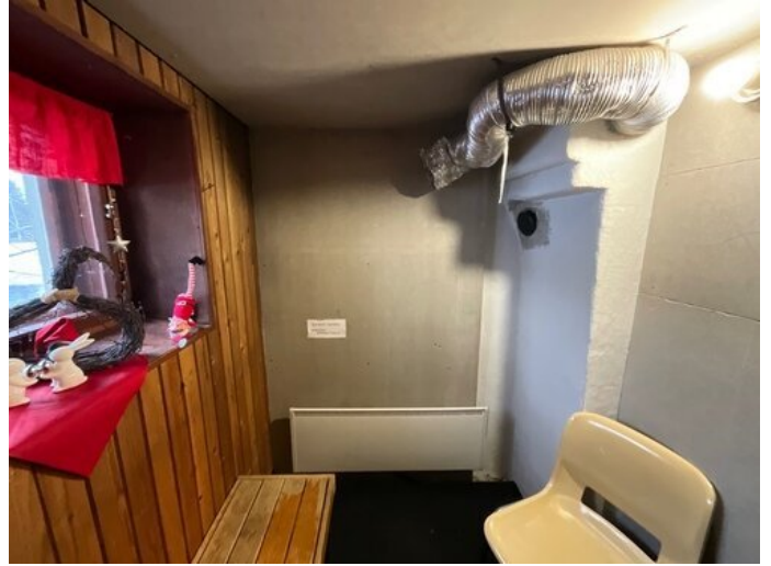
Kuva 6 Naisten pukuhuoneen, entisen saunatilan seinillä harmaana näkyvissä asbestipitoinen kuitusementtilevy
