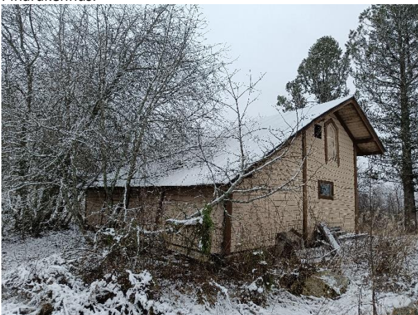
Piharakennuksen katto vaikuttaa vaurioituneen, oikealla saunarakennus.
